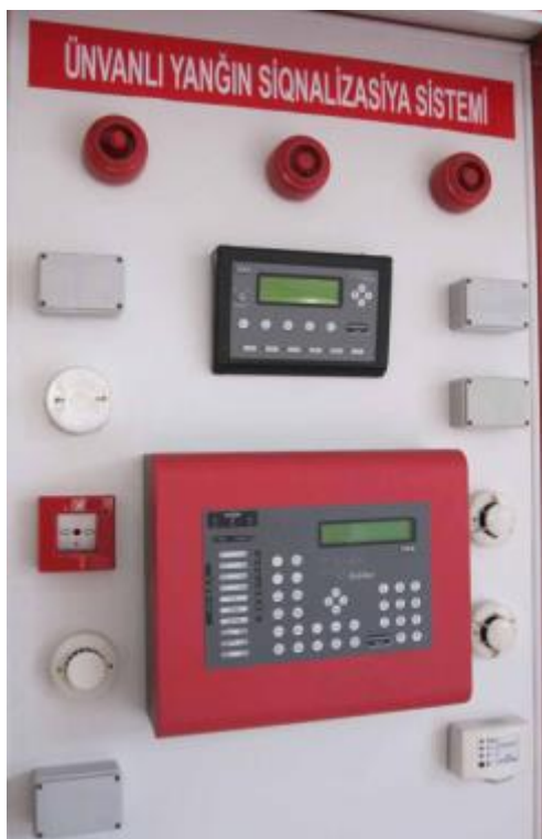
Şəkil 4.32. Yanğın siqnalizasiya sistemi
