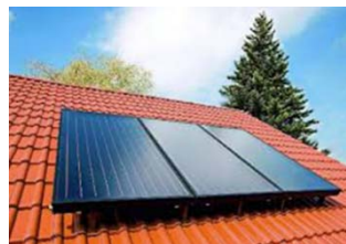
(а) Кремниевые солнечные батареи
