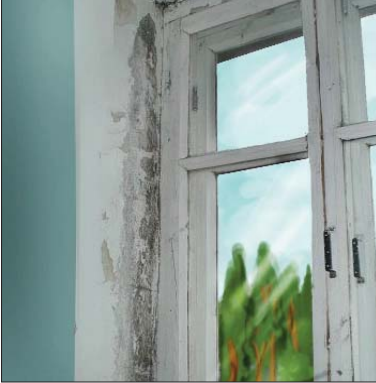
Şəkil 1. Köhnəlmiş pəncərə çərçivəsi
