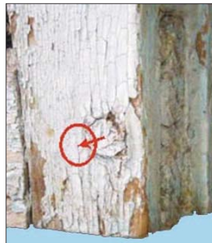
Şəkil 5. Ağac mıxla bəndlənmiş pəncərə
