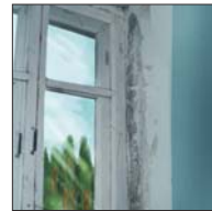
Şəkil 1. Köhnəlmiş pəncərə çərçivəsi
