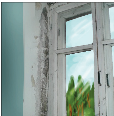
Şəkil 1. Köhnəlmiş pəncərə çərçivəsi
