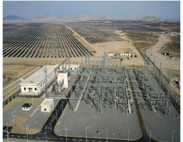
§.3.7. Qaradağ Günəş Elektrik Stansiyası (Bakı, Azərbaycan, 26 oktyabr 2023).
